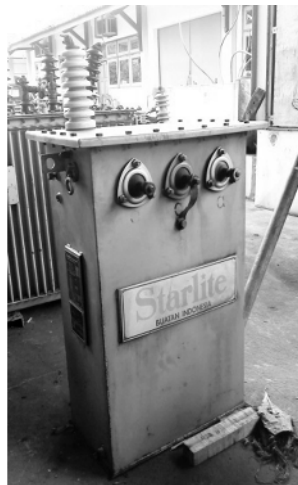
Gambar 2 Konstruksi transformator 1 fase merk Starlite.
