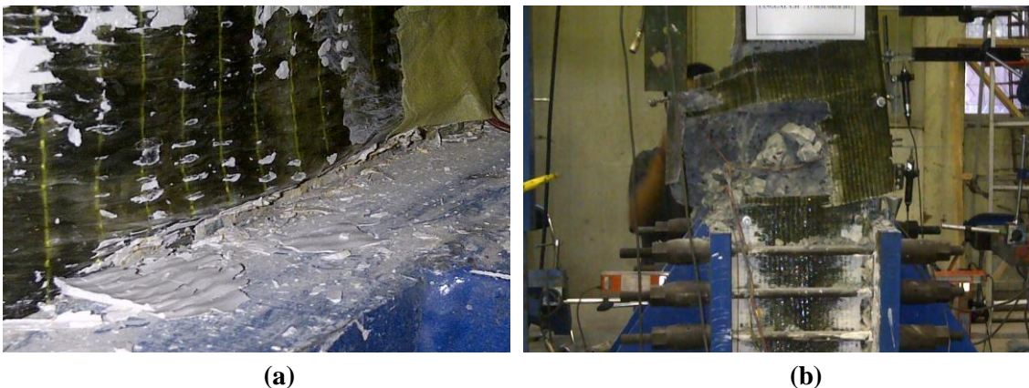
Gambar 9. Kolom C-1RG: (a) Retak pada Daerah Sendi Plastis, (b) Retak dan Spalling pada Ujung Kepala Kolom
